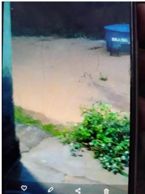
Foto 11: Entrada alagada de uma das casas.
