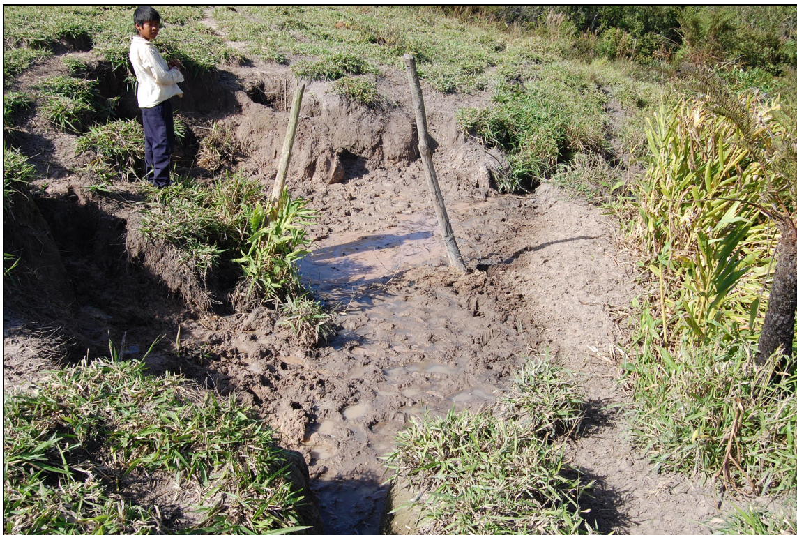
Área com erosão na comunidade indígena Itakyry. Fonte: Base IS
